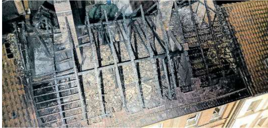
Der Blick von oben zeigt, dass der Dachstuhl völlig ausgebrannt ist: Das Mehrfamilienhaus am Braunschweiger Tor wurde durch das Feuer derart zerstört, dass es nun unbewohnbar ist. Foto: Feuerwehr Helmstedt
